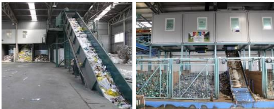
Slika 4.2 Izgled postrojenja za separaciju otpada
